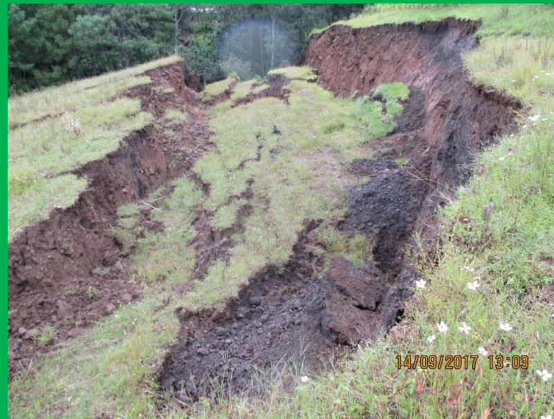
“escalón” en ladera producto de deslizamiento
