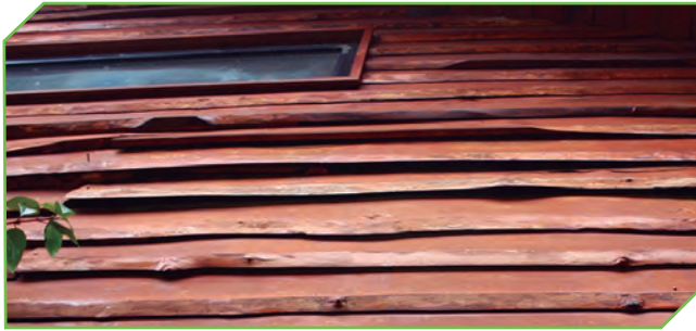
Figura 19. Incorrecto revestimiento horizontal.
